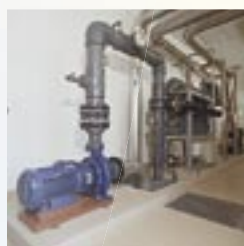
■ Contrôle de pompe
